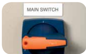
Identyfikacja Paneli Elektrycznych
